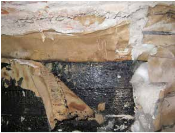
Vuonna 1952 rakennetussa talossa kellarin seinässä oli käsin tehtyä mineraalivillaa. Eristeen molemmilla puolilla oli kreppipaperi.
