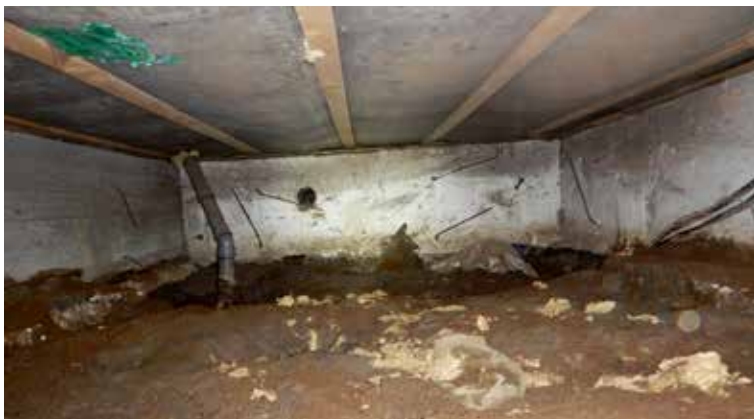
Alapohjan kosteusvaurioita tuulensuojalevyissä. Maapohja on savea.
