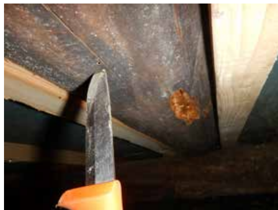
Hirsien hyönteisvauriot eivät välttämättä näy ulkopinnassa.
