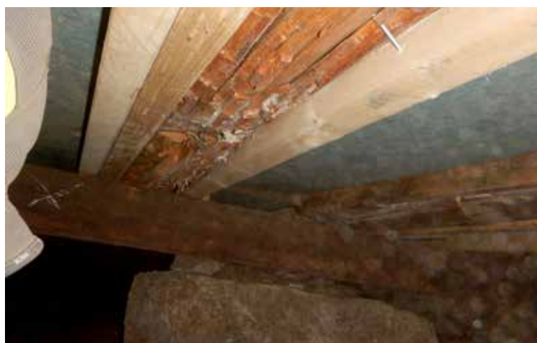
Kertaalleen korjattuun alapohjaan on jätetty lahovaurioituneita hirsiiä.
